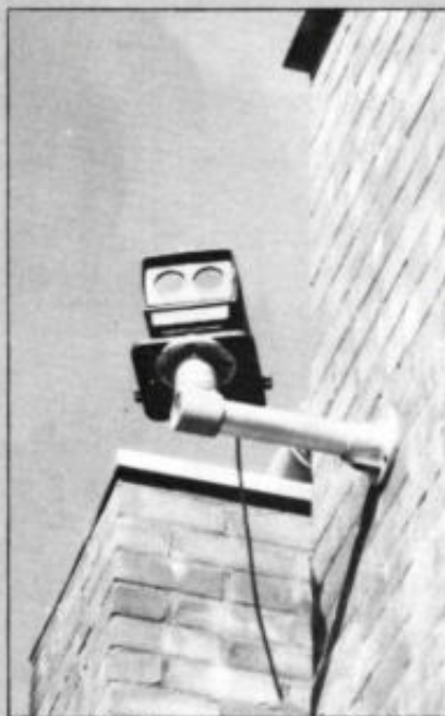
Geïnstalleerde zend/ontvang-eenheid van het bidirectionele systeem Interlaser van Modular Technology.
